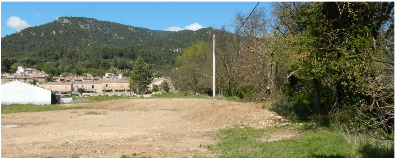
Figure 60 : Zone de remblai au 22/04/21, vue vers l'amont, rive droite du Raby en amont de la confluence avec le Latay
