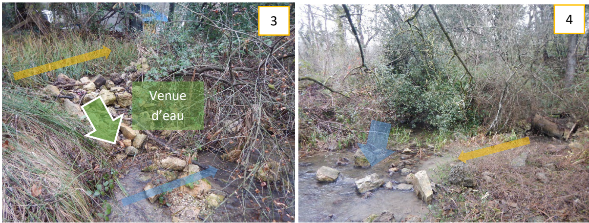
1 : Amont de la dérivation - 2 : Canalisation au droit des habitations rive gauche - 3 : Venue d'eau à travers l'ouvrage - 4 : Restitution du débit, vue vers l'amont
