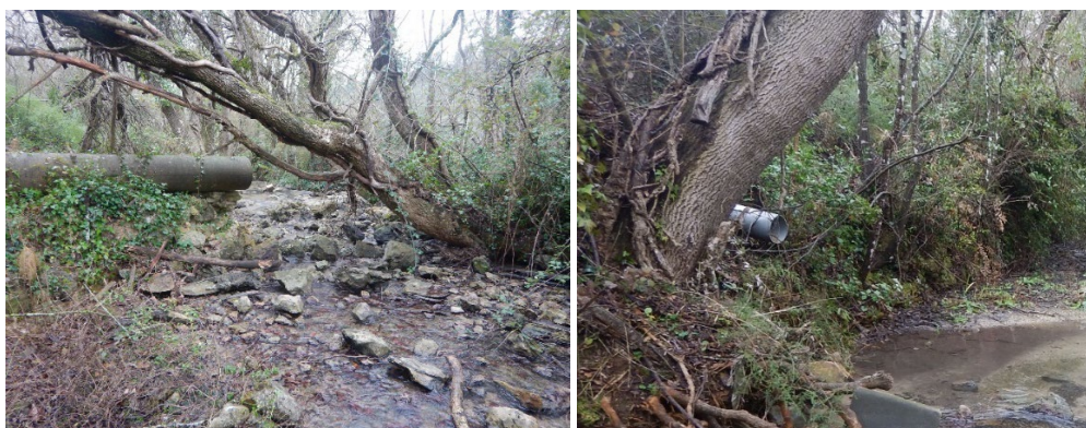
Rejets en rive gauche du Gapeau
