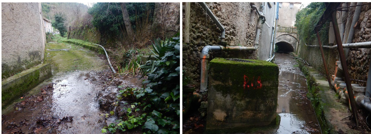
Prélèvement d'eau et réseau d'eau usée dans la traversée de Signes
