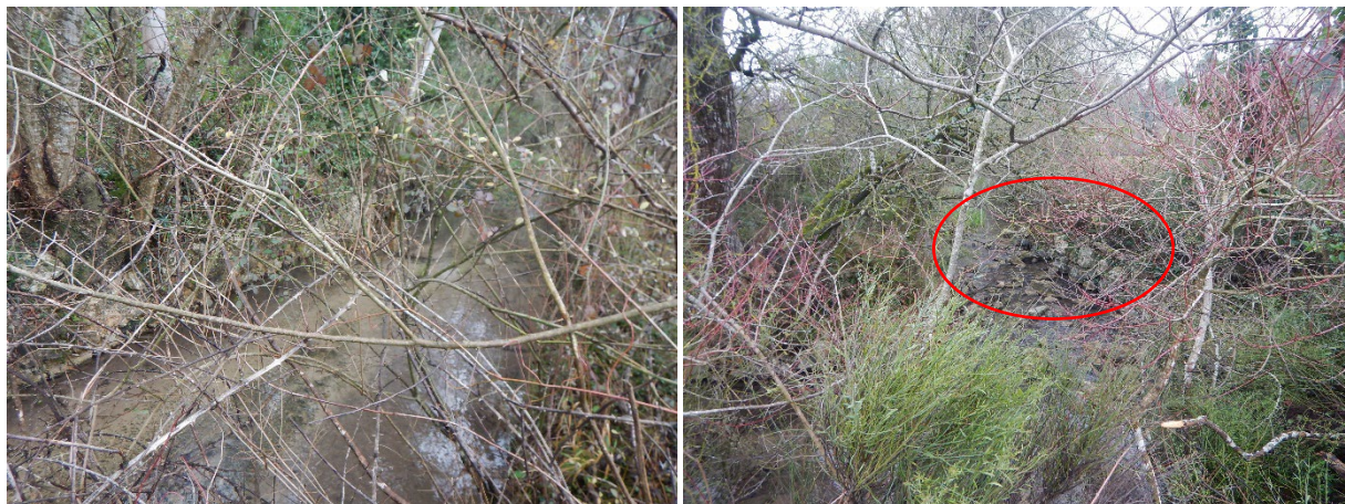
Exemples de protection de berge : mur dégradé du bief à l'aval du moulin et enrochements en extrados dans la parcelle agricole
