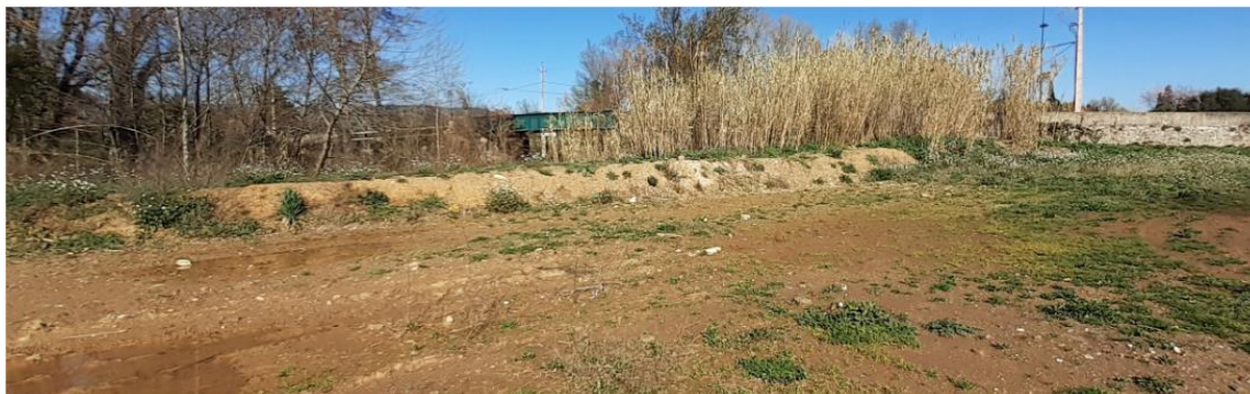
Merlon de terre installé en rive gauche du Réal martin à l'aval du rond-point de la RD14 et créé à partir de matériaux provenant de la parcelle à la suite de travaux d'aplanissement
