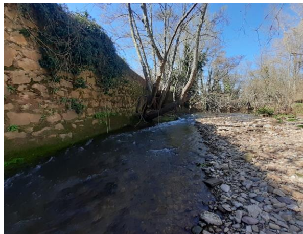
Observation du phénomène de tri granulométrique des éléments les plus grossier sur un atterrissement situé au droit d'une protection de berge
