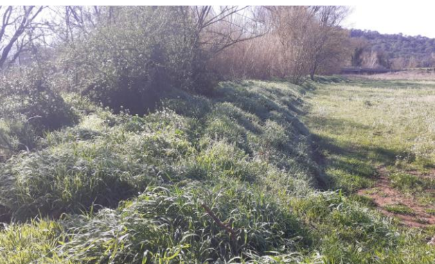
Digue en remblais en rive droite du réal martin en amont de la RD14
